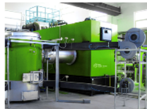
Une centrale automatisée et démarrée en Sicile
